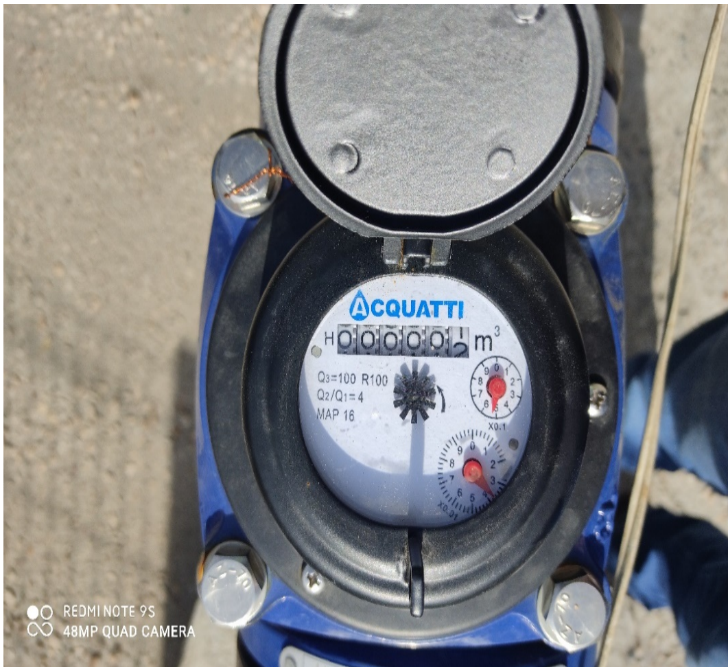
Fotografía 7. Medidor volumétrico instalado en el pozo pz-19-0026
